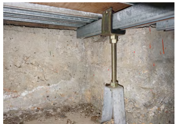
写真 29. 基礎と鉄骨柱の接合が確認できない。
