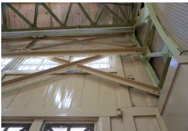
写真 28. 後補の筋交と振止めの根拠が不明.
