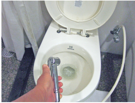
写真22. トイレとハンドシャワー
