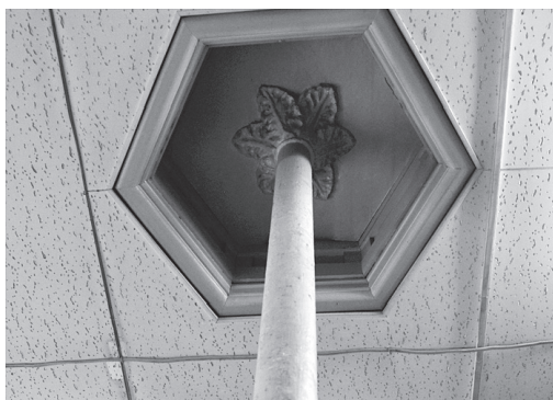
図13 照明器具収納飾り
