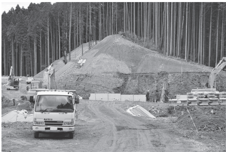
写真－1 設楽町田口地区西部（清崎下の沢）の道路工事ののり面に現れた断層露頭、西側から東に向かって撮影、2016年4月2日。その後、のり面全体がコンクリート構造物とモルタル吹き付けによって覆われたので現在は見ることはできない。
