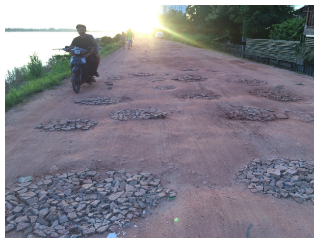
写真7 割れた石材等で穴埋めされた道路 撮影: 難波美芸.
